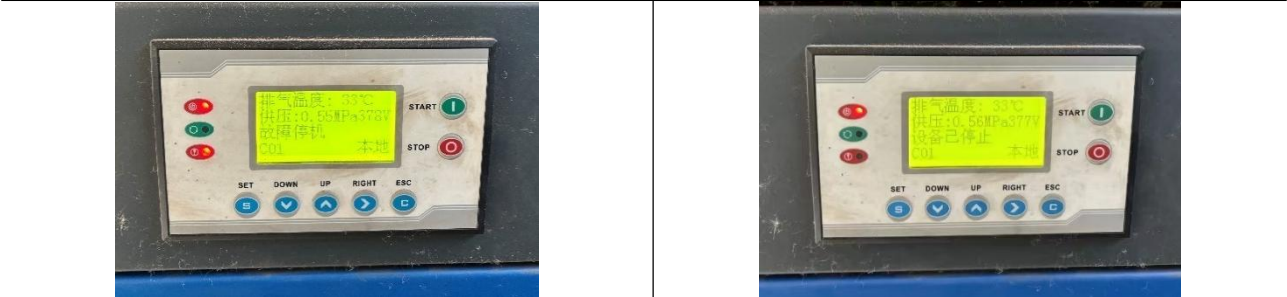
F10 CEMS 空压机检修前
