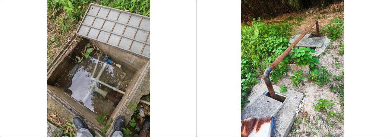
F8 生活给水管道改造前
